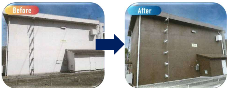
変電所(コンクリート)
