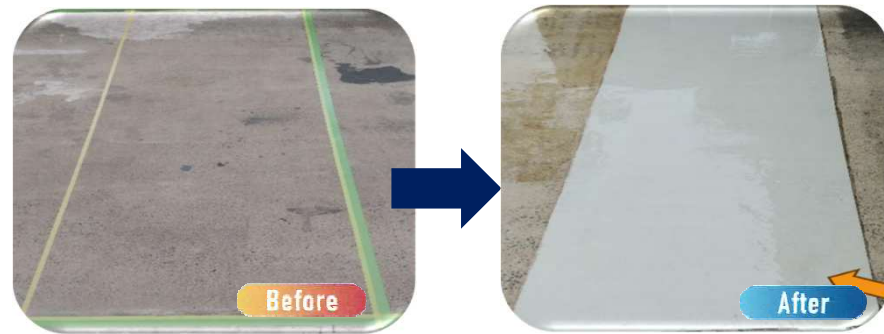
コンクリート床(復活パワーコートT)
